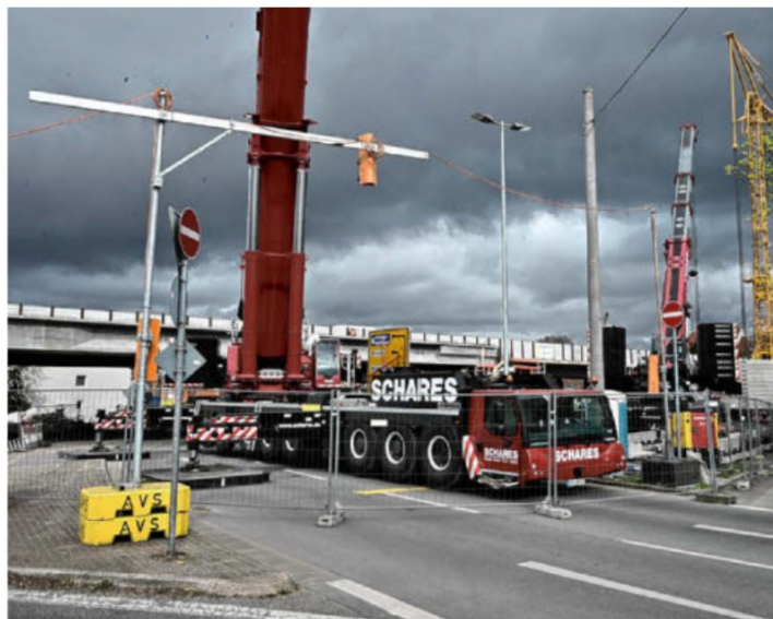
Die Schwertransporte müssen die Straße Dreilinden queren, die am Freitag, 27. März, für den Stadtverkehr wieder befahrbar sein wird.
